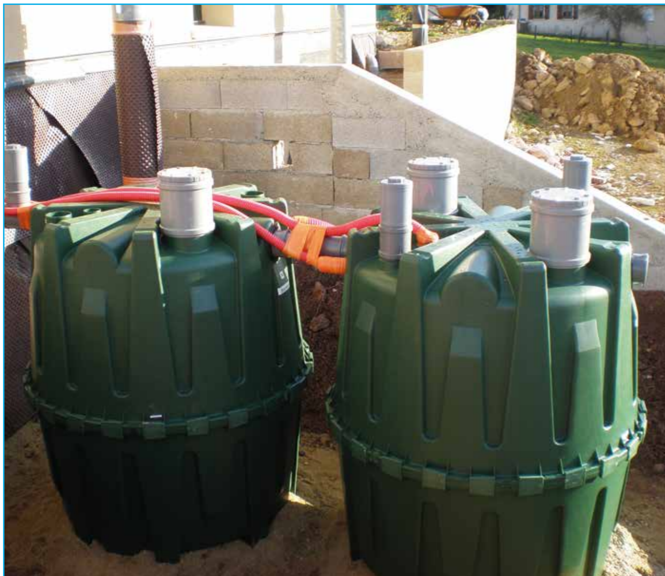
Le document du 16 octobre 2023 et la note du 23 octobre 2023 ne prévoient pas de règle spécifique pour les installations agréées qui ne sont pas enterrées dans la parcelle, mais posées comme ici sur le sol en place et recouvertes d'un talus. Dès lors qu'elles sont situées à moins de 5 mètres d'un bâtiment fondé, il faut demander une étude à un bureau d'études compétent.
