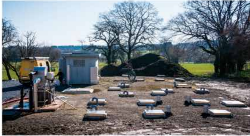
Filière complète de prétraitement et traitement pour la brasserie industrielle lupulus
