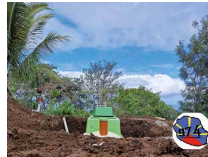
Installations de micro-station pour maison individuelle.
