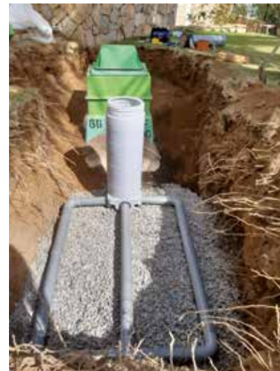
Installation de micro-station pour maison individuelle.
