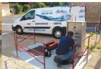
Postes de relevage
