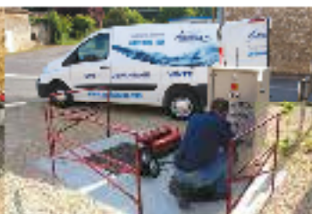
Postes de relevage
