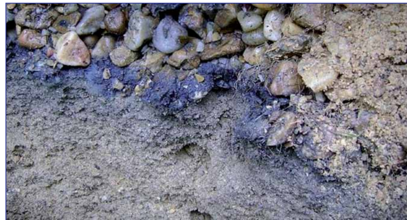
Le colmatage du dispositif crée des conditions anaérobies, que révèlent les traces noires, en particulier à l'interface entre les gravillons (en haut) et le filtre à sable (en bas).
